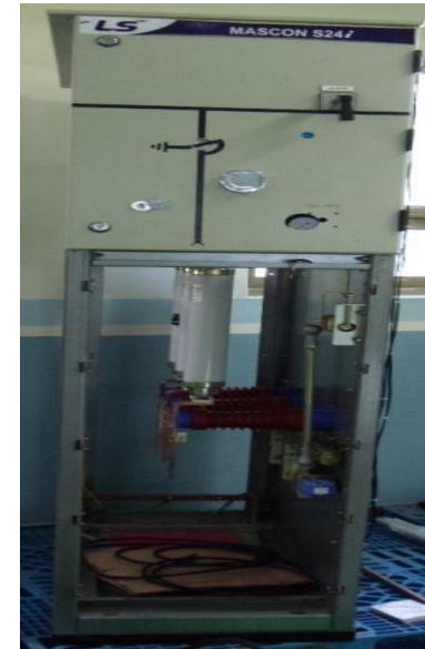
配電盤内に設置 (FRONT VIEW)
