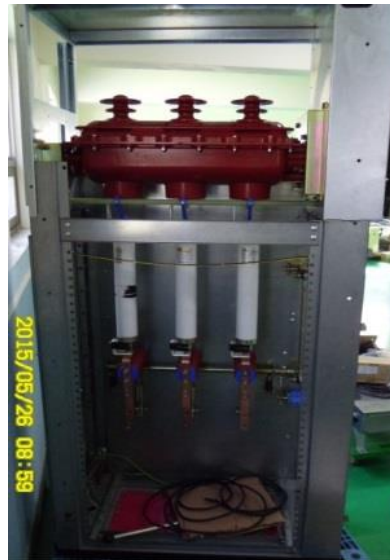
配電盤内に設置 (SIDE VIEW)
